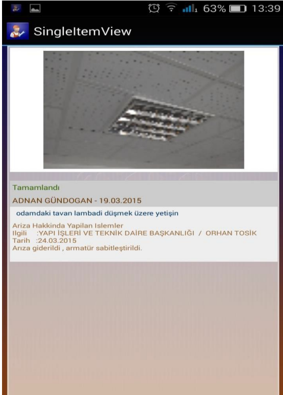
Şekil 7 Tamamlanan Arızanın Detayı
